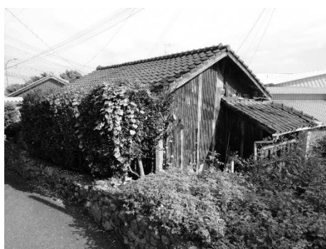
外壁剥落・瓦落下
