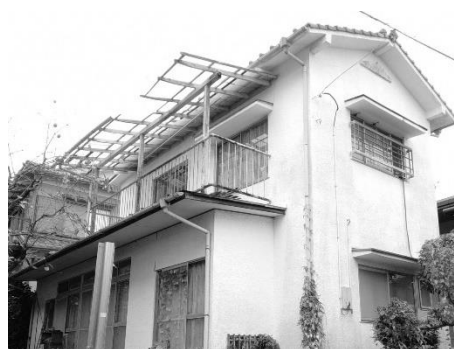
ベランダ屋根剥落
