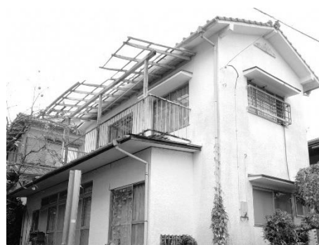
バルコニー屋根剥落
