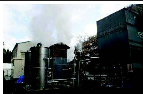
松之山温泉における実証施設(全景) 資料：新潟県 HP
